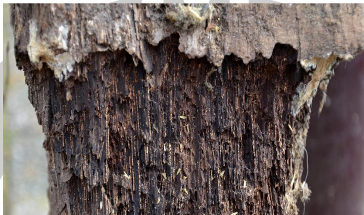
شکل ۳- خسارت ناشی از عدم استفاده از مواد ضد عفونی‌کننده روی چوب
