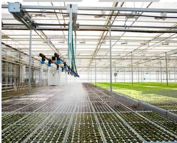
شکل ۱- سیستم مه‌پاش در گلخانه
