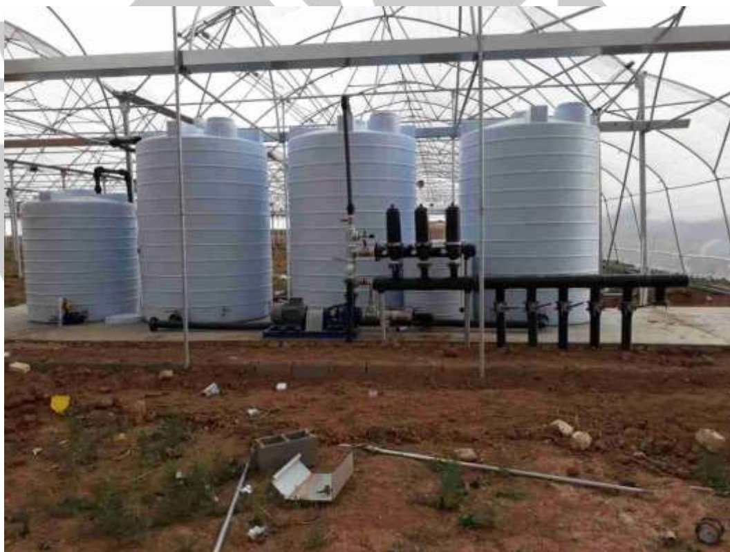
شکل ۱- تجهیزات سیستم آبیاری گلخانه
