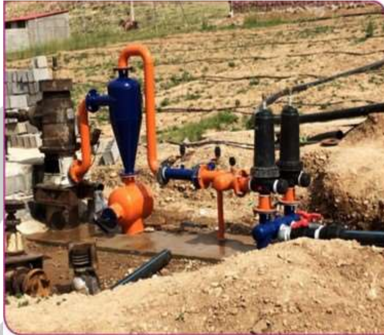
شکل ۲- سیستم فیلتراسیون در ایستگاه کنترل مرکزی
